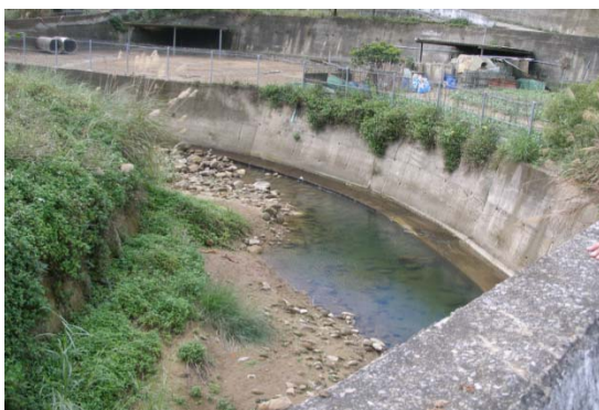
圖一 護岸基礎被沖蝕
